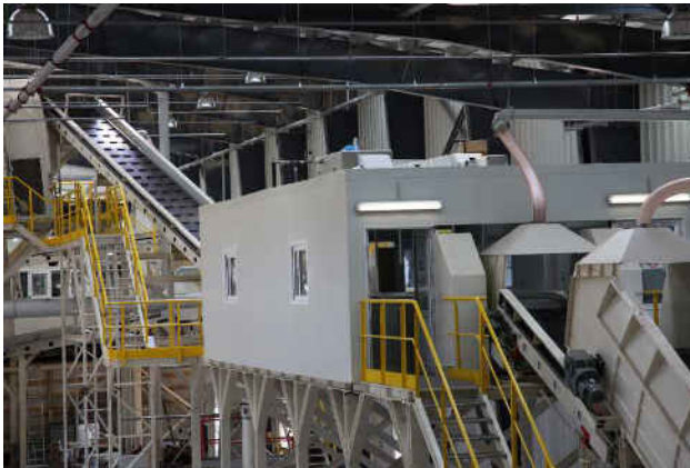
Εικόνα 3. Εσωτερικό εγκατάστασης ΚΔΑΥ Κρωπίας της WATT.
