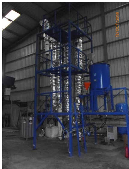
Ολοκληρωμένη μονάδα αεριοποίησης με ρευστοποιημένη κλίση ανακυκλοφορίας.
